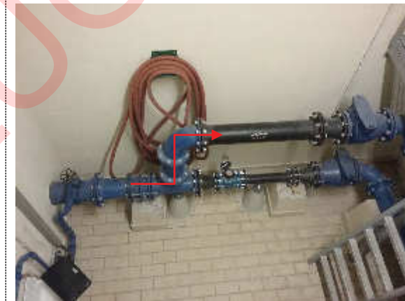
Abbildung 18 – Zu- und Ablauf im Rohrkeller
